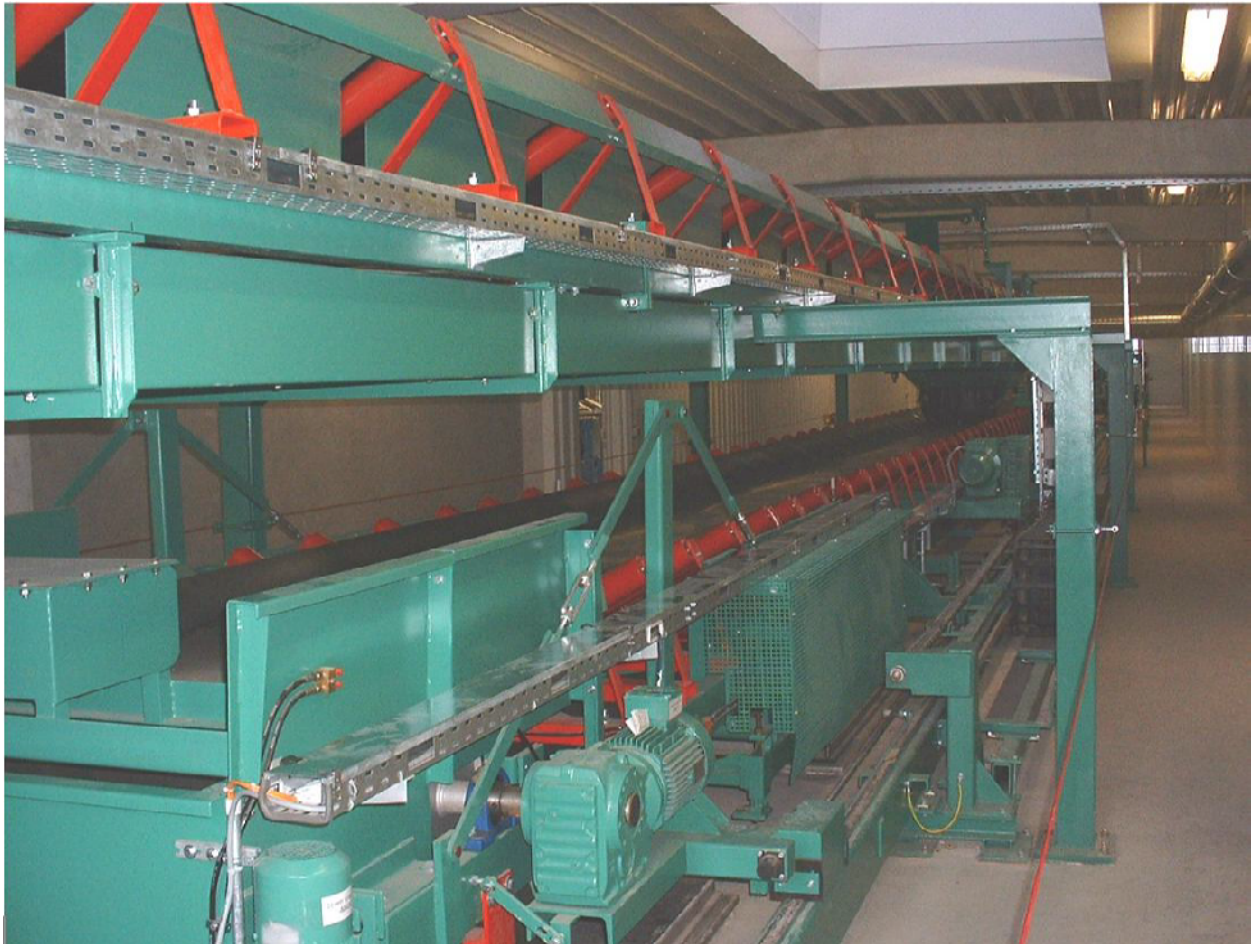
Abbildung 7 Fördersystem auf dem Tunneldach
